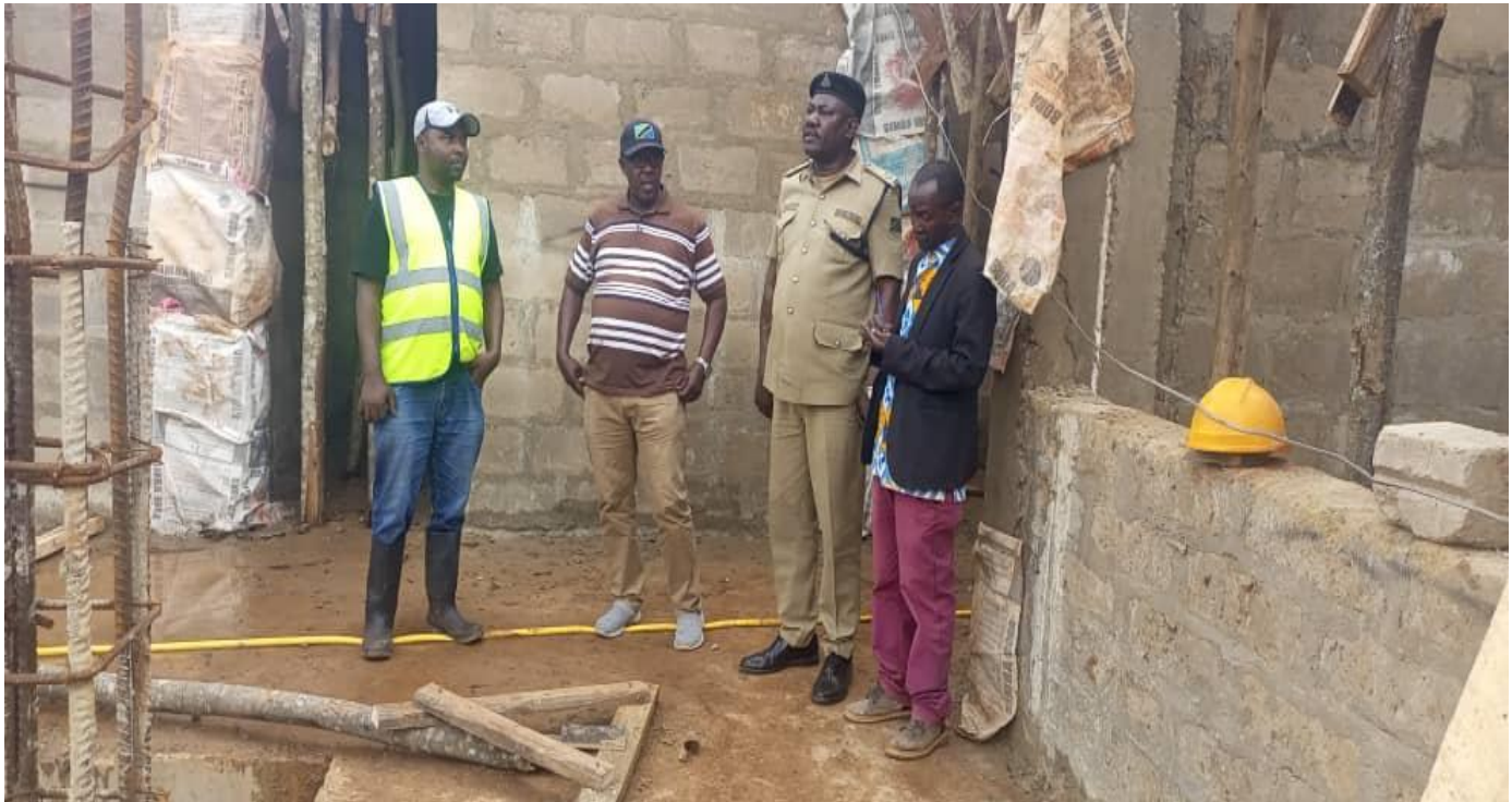
Mkuu wa Wilaya Ngara Kanali Mathias J. Kahabi akikagua jengo la makao makuu ya Halimashauri ya Wilaya Ngara tarehe 17.02.2024.
